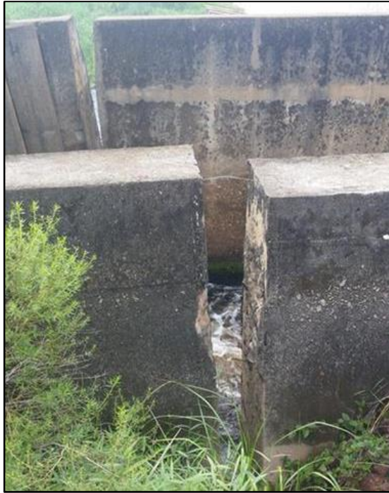
Figura 33 ï Detalhe do rompimento do canal de restituição do lado esquerdo do vertedouro
