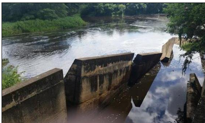
Figura 26 ĩ Estrutura de concreto rompida do lado direito do vertedouro
