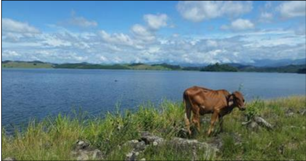
Figura 18 ï Gado circulando livremente na crista da barragem
