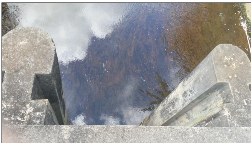
Figura 43 i Estrutura para descida dos stop-logs do canal de restituição do lado esquerdo
