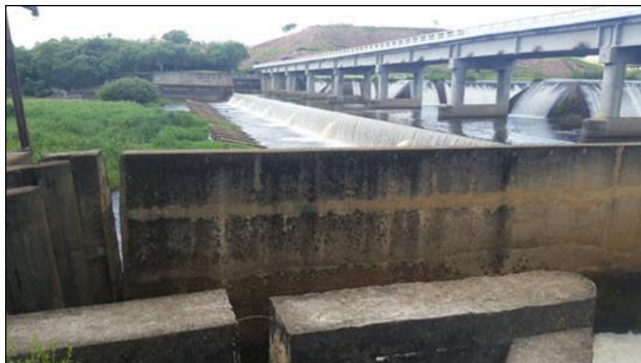
Figura 32 ĩ Colapso do canal de restituição do lado esquerdo do vertedouro
