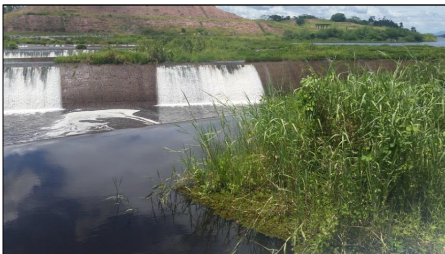
Figura 40 ï Presença de vegetação em cima do vertedouro
