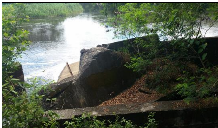
Figura 29 i Estrutura colapsada do lado direito do vertedouro
