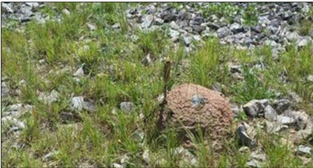
Figura 19 ï Cupinzeiros na crista da barragem
