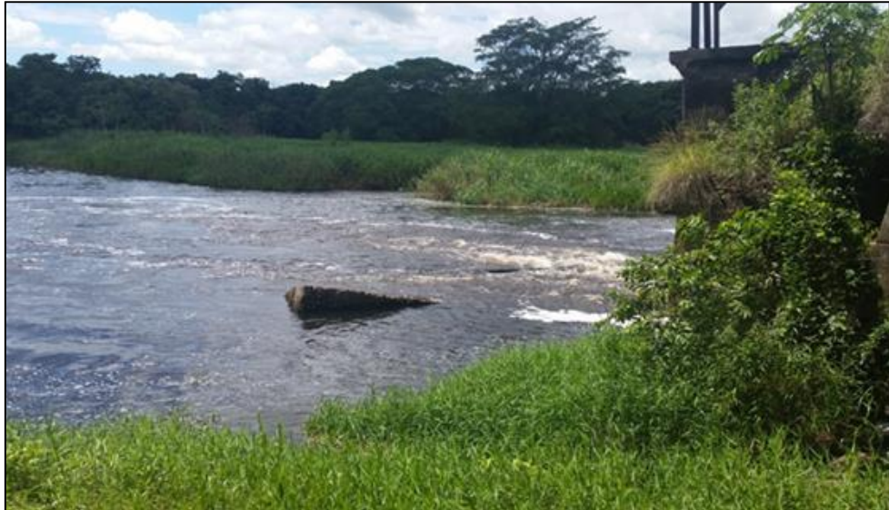
Figura 34 ï Bloco de concreto do canal de restituição que se separou do lado esquerdo do vertedouro
