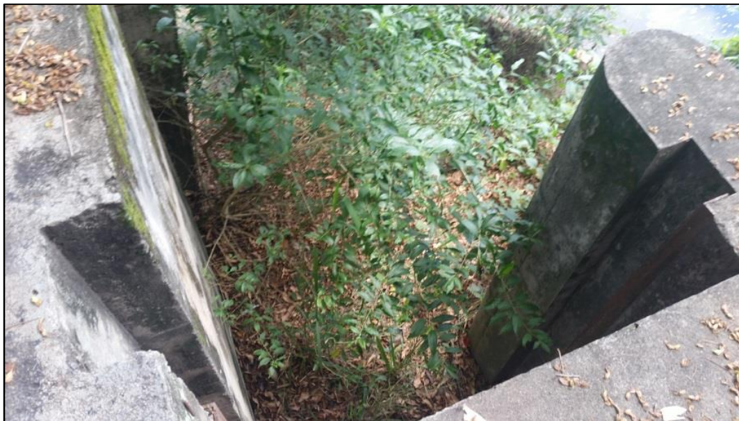
Figura 42 i Estrutura para descida dos stop-logs do canal de restituição do lado direito
