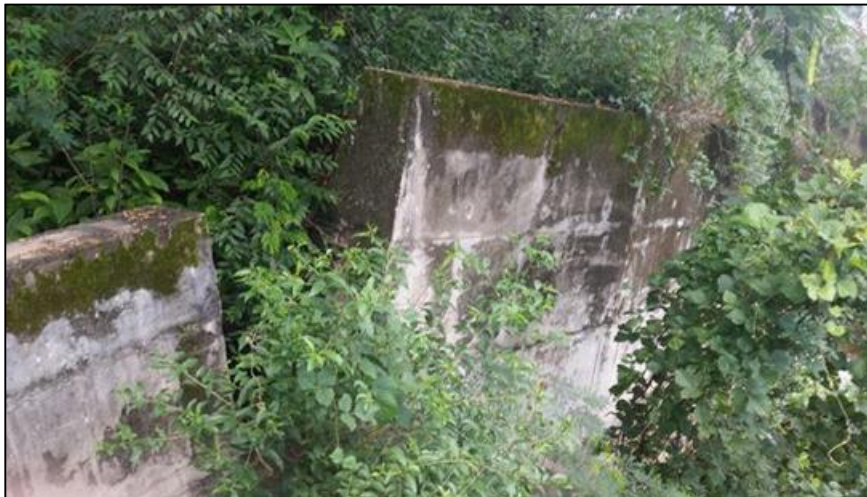
Figura 28 i Detalhe dos blocos de concreto rompidos do lado direito do vertedouro
