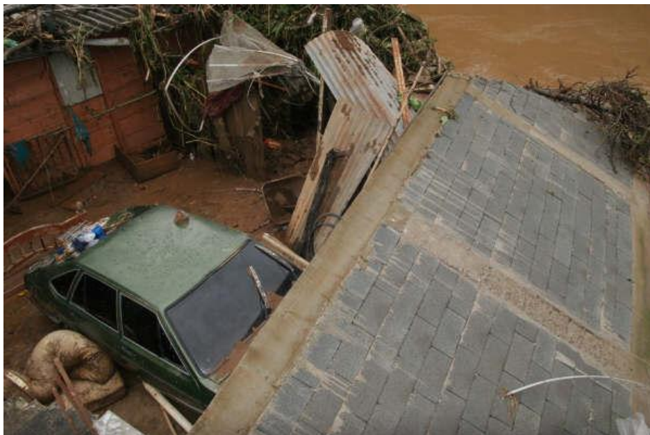
7.12 - Foto: Queda de muro causando vítima a jusante da Estr. do Gentio as margens do Rio Santo Antônio.
