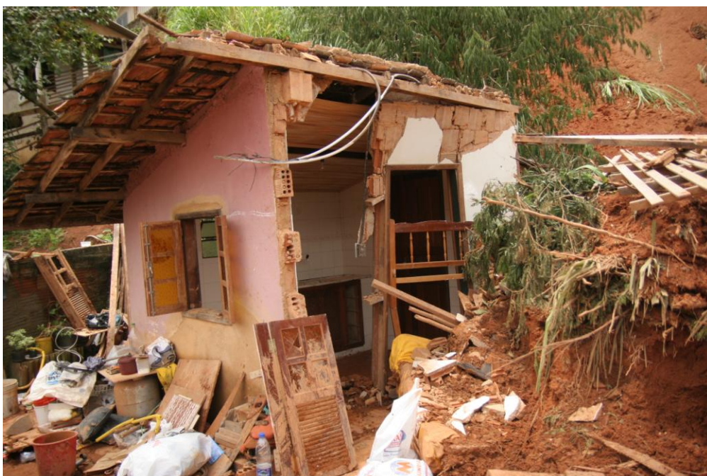
7.13 - Foto: Edificação atingida por deslizamento de encosta na Estr. do Gentio
