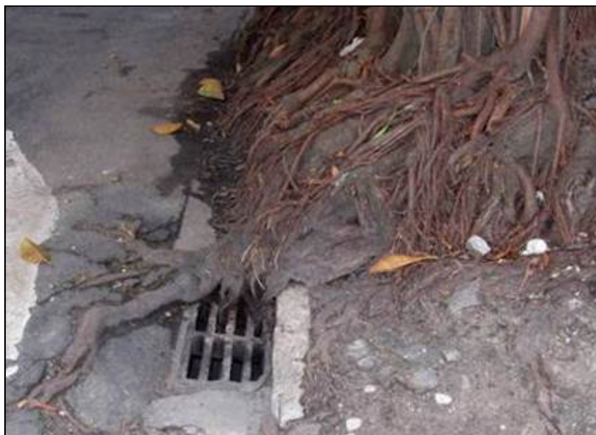
Foto 16 – Obstrução de bueiros por raízes (visível – na superfície) de árvore Fonte: WELLINGTON VIEIRA, 2000.
